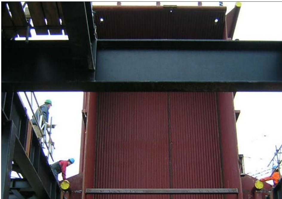
Den enorme kedel bliver hejst ind på affaldskraftvarmeværket af tre omgange. Når den er installeret, kan den klare ti ton affald i timen. FOTO: BABCOCK & WILCOX, VØLUND.
