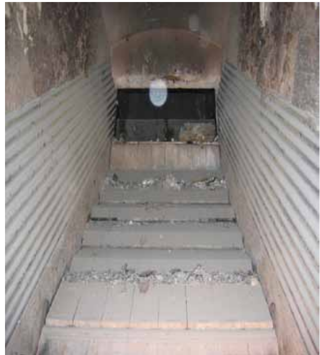
Ombygget anlæg i Thorshavn. Anlægget har en kapacitet på 2 t/h, og er her vist efter 4000 timers drift.
