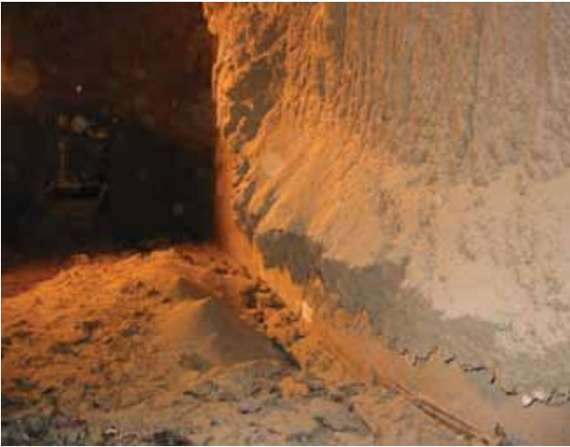
Slaggepåbagning over risten
