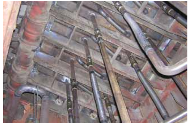
Rørføring på anlægget i Hässleholm. Vandføringen under risten er udført i stålrør med flexforbindelser af stål.
