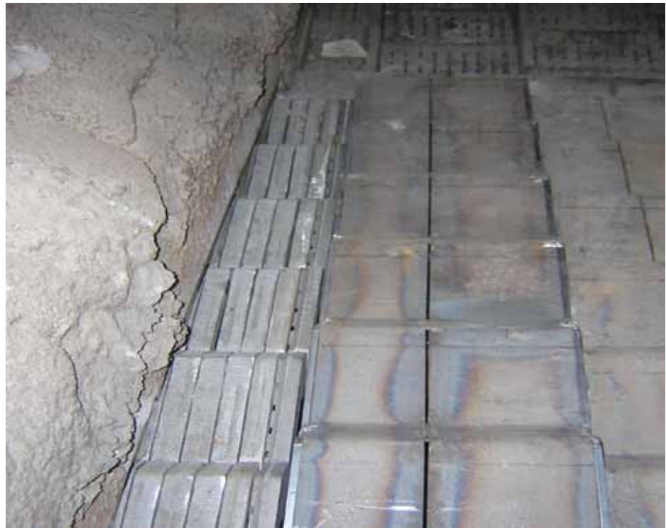
Grate bed at Häsleholm Fjärrvärme, Sweden
